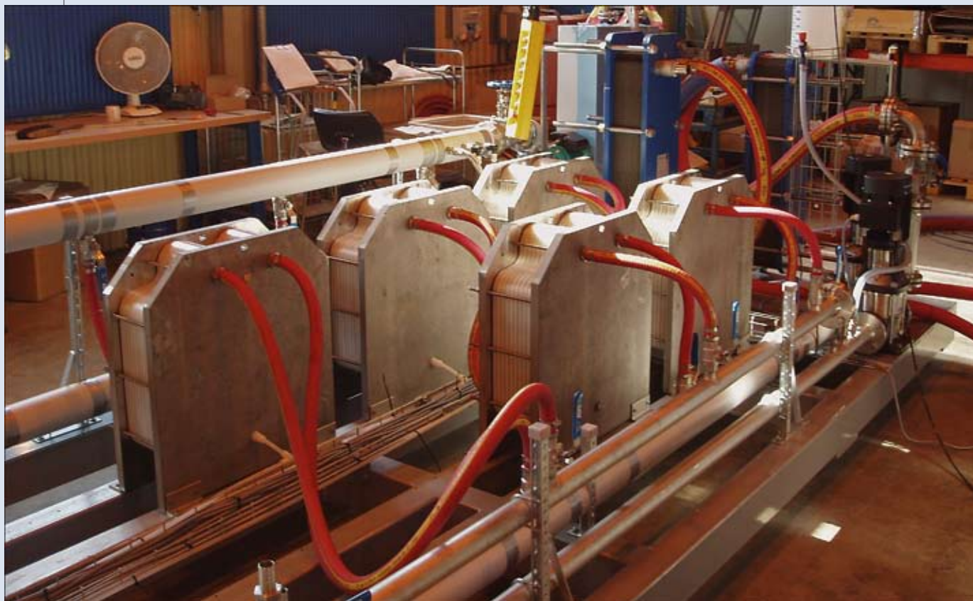
Anläggning med fem moduler
