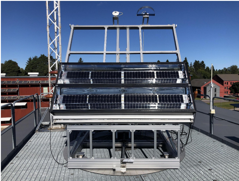
Bild från installationen av mellangeneration av koncentrerande hybrid-solfångare i en specialbyggd testrigg.
