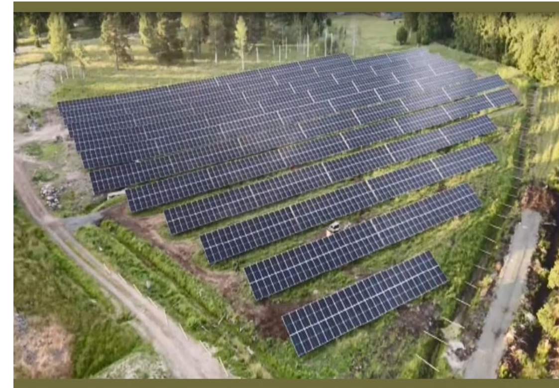
Carlfors Bruk solcells park Installerad effekt: 1 200 KW Installationsår: 2021 Beställare: Carlfors Bruk Byggdes i anslutning till en industri och kopplades in bakom mätaren
