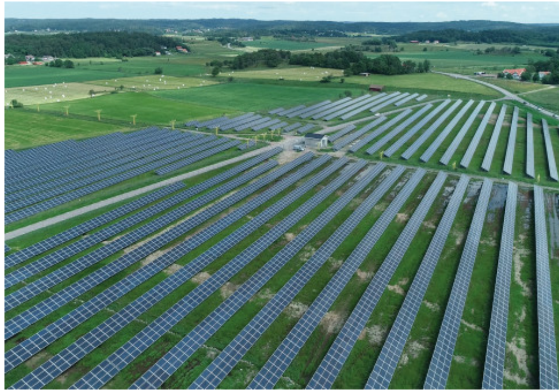
Utby solcells park Installerad effekt: 5 500 KW Installationsår: 2020 Beställare: Göteborgs Energi Sveriges största upphandling för solparker 2020
