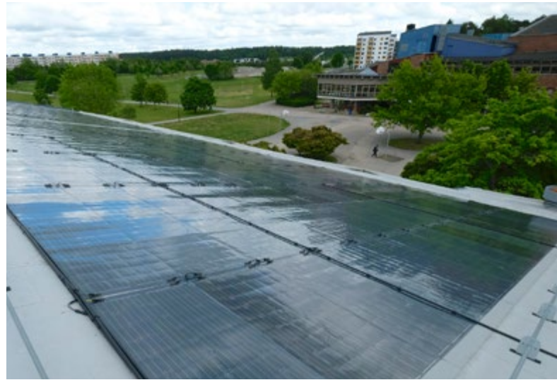
Paneler installerade på Tele2 Arena och Vikingahallen
