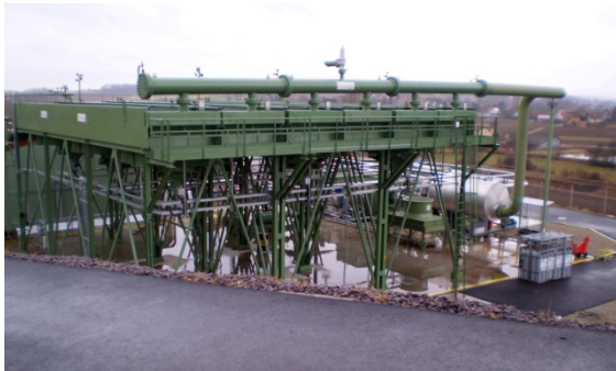
Fig 4: Kraftverket Soultz-sous-Forêts i Alsace. Kraftverket (1,5 MWe) är den silverfärgade cisternen till höger medan fackverksbygget är kylfläktarna som motsvarar kyltornet i Fig 3
