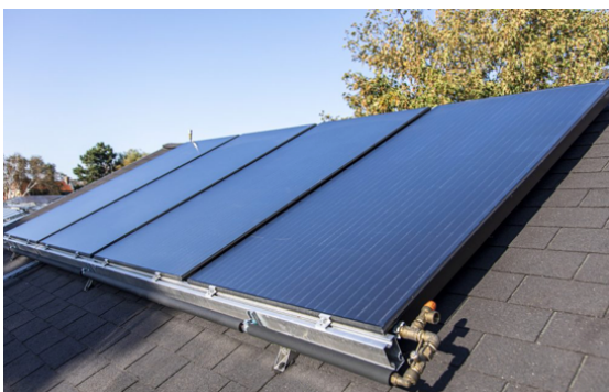
Solarus arbetar främst med större installationer, men framförallt i Nederländerna görs ibland även mindre installationer. Bilden visar del av en av Solarus mindre installationer.
