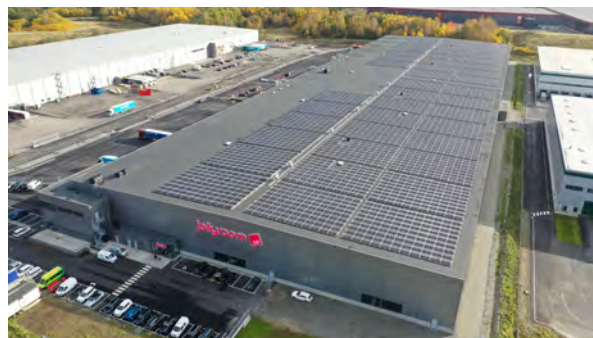
En av Nordeuropas största takbaserade solcellsanläggningar på en logistikanläggning ägd av Castellum. Totalt 35 000 m 2 som producerar 3,3 MWh per år. Levererad av Soltechbolaget Swede Energy.
