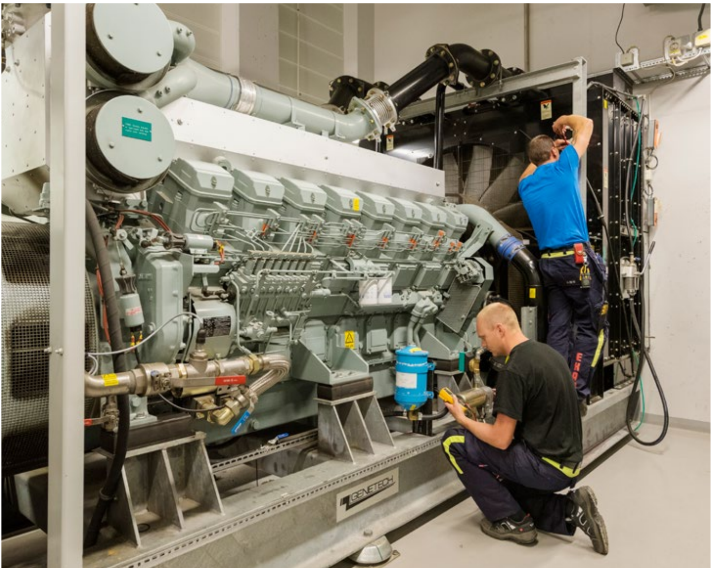
Förebyggande service på reservkraftsanläggning (EKAB)
