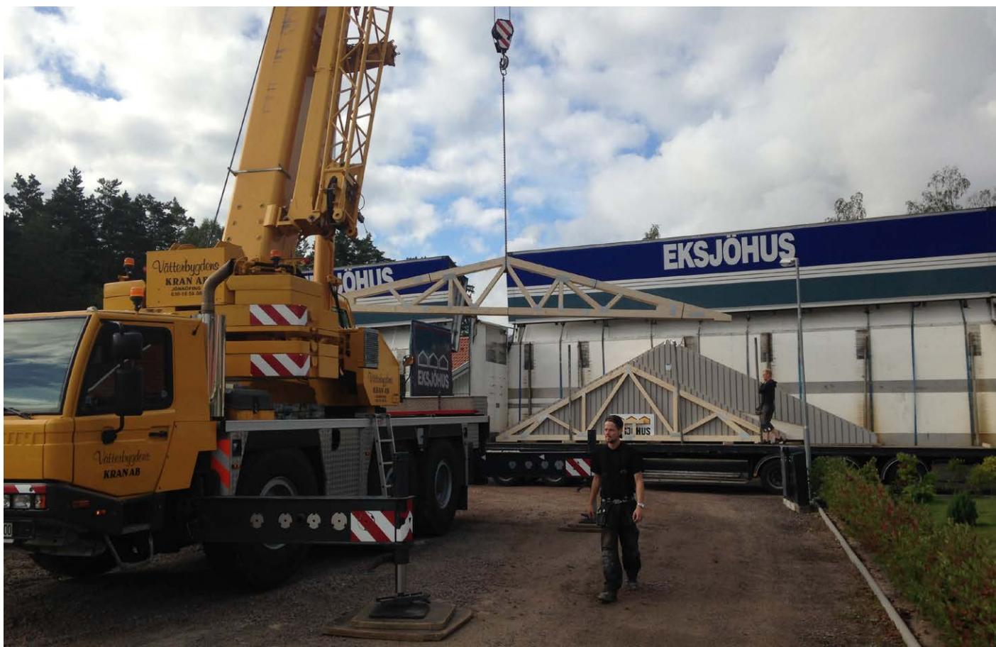
I augusti 2015 monterades det senaste huset på vårt område Kompassgränd i Vimmerby.
