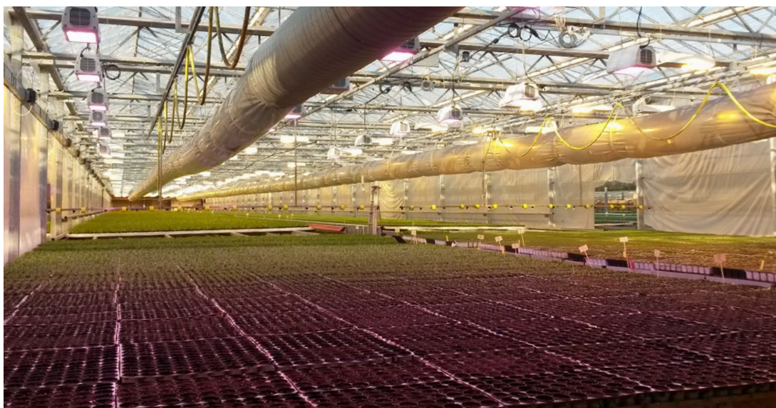
Första installationen av LX60 i ett av Swedeponics växthus.
